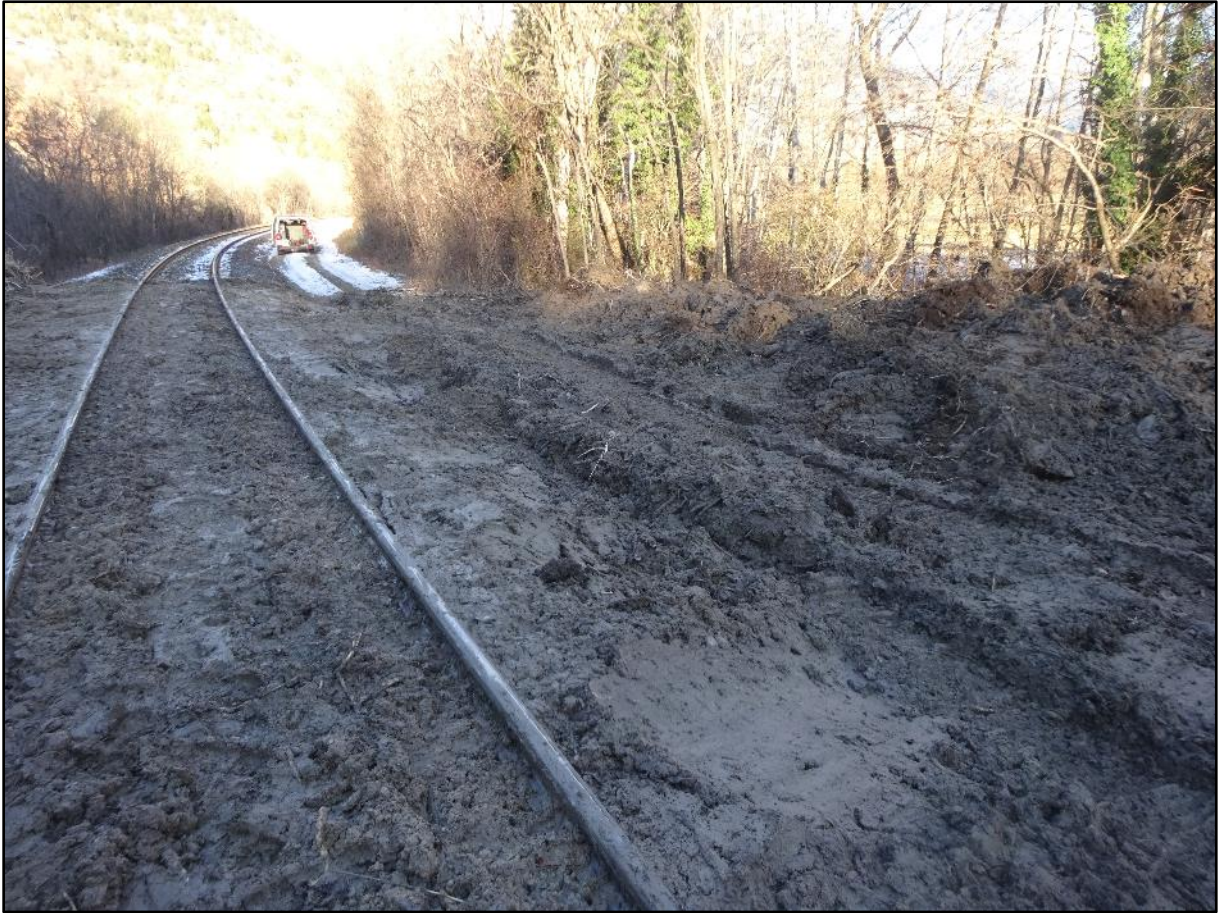
Image 33 : de la boue sur les rails
