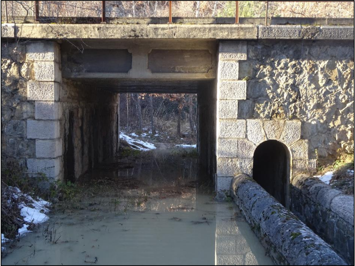
Image 34 : le pont du Sourt inondé
