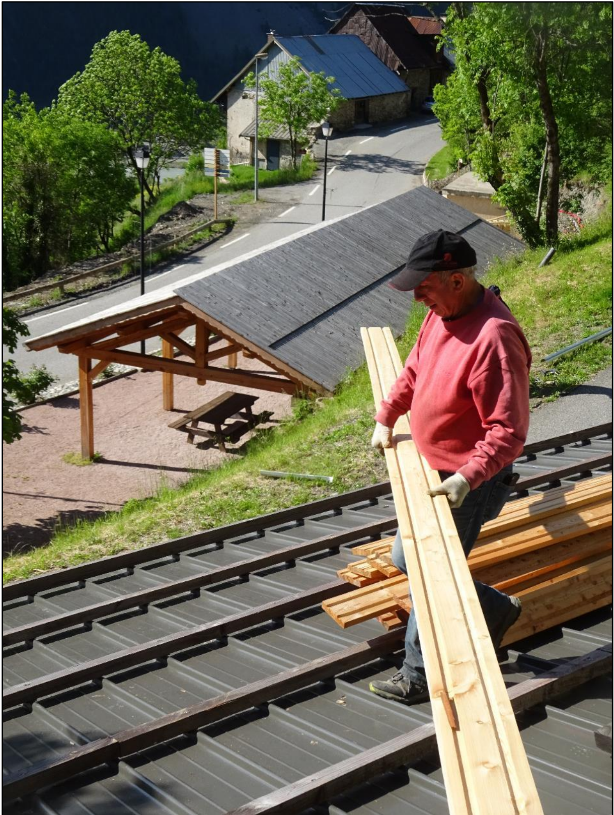
Image n°21 : sur le toit
