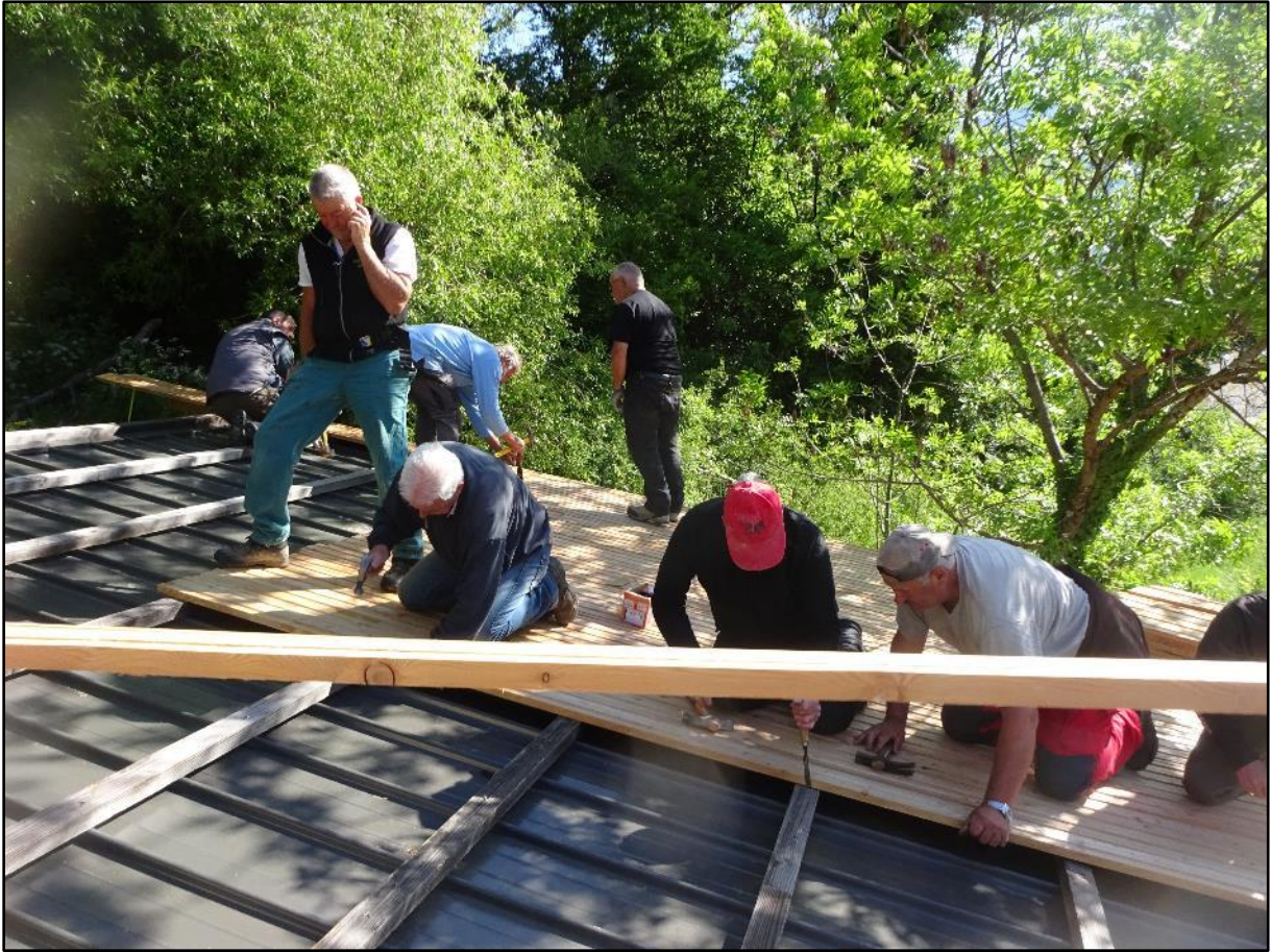
Image n°17 : sur le toit
