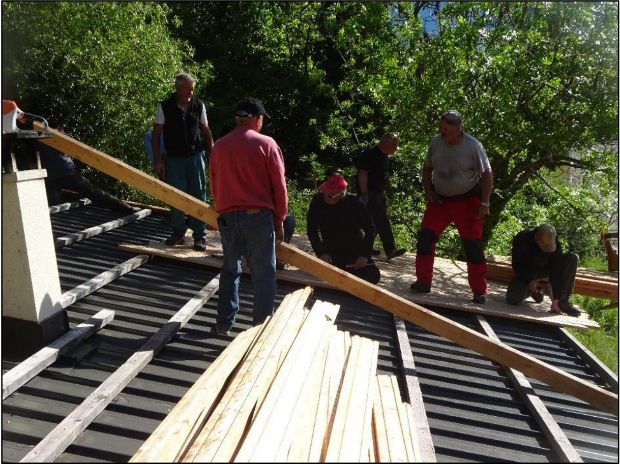
Image n°16 : sur le toit
