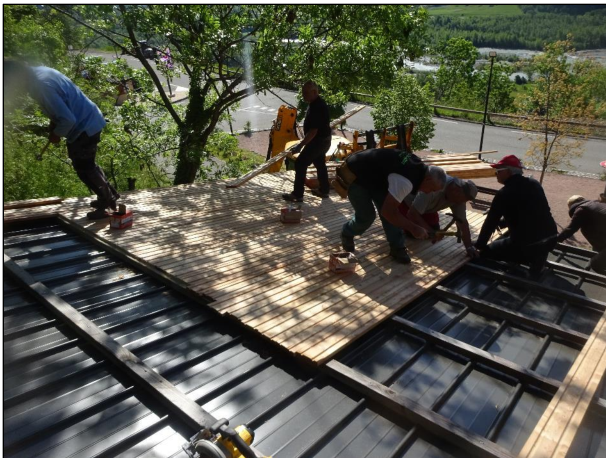
Image n°19 : sur le toit
