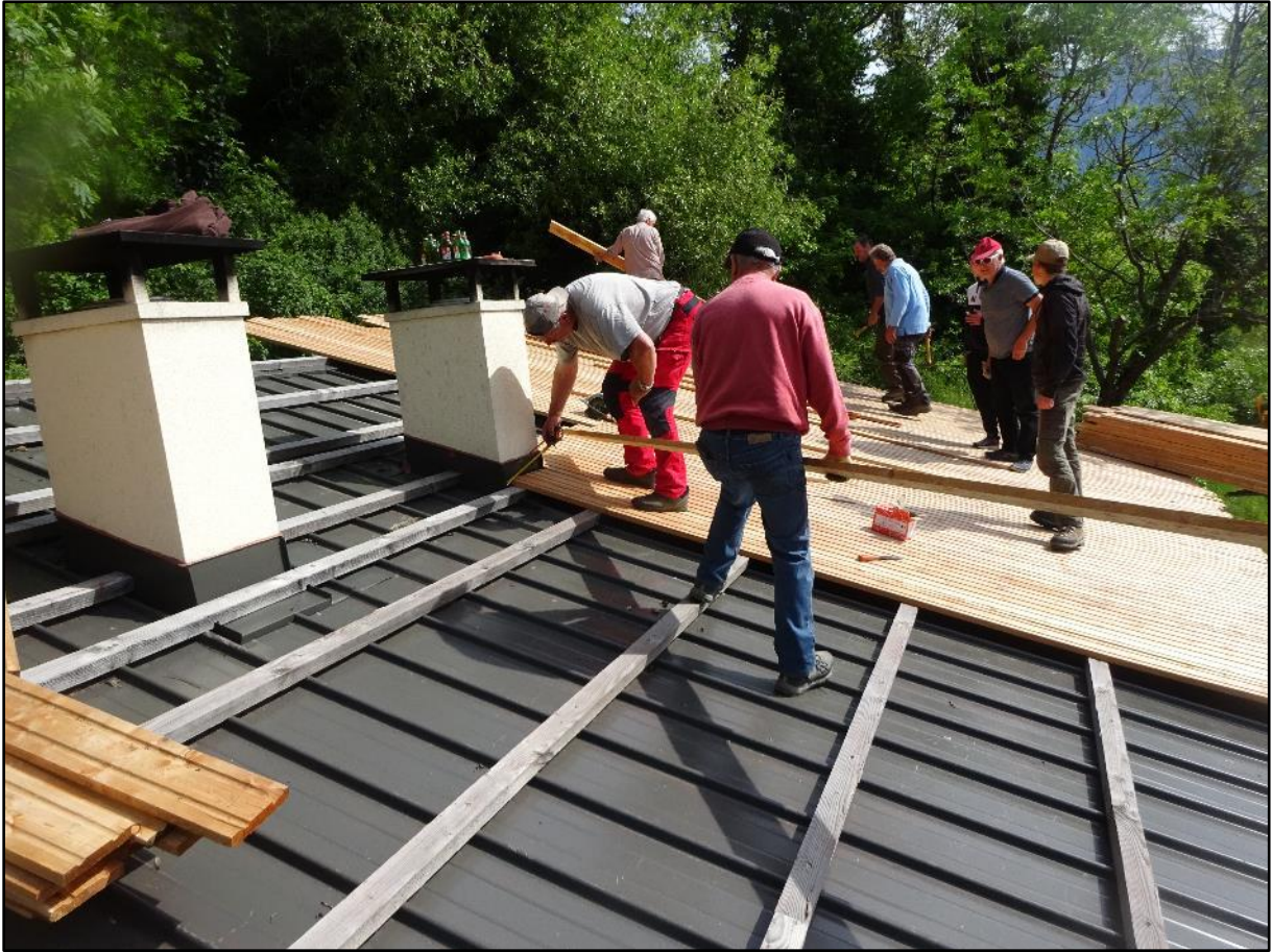
Image n°23 : sur le toit
