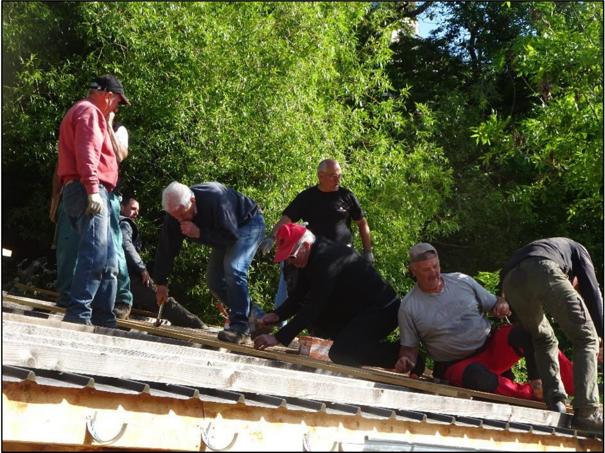
Image n°15 : sur le toit
