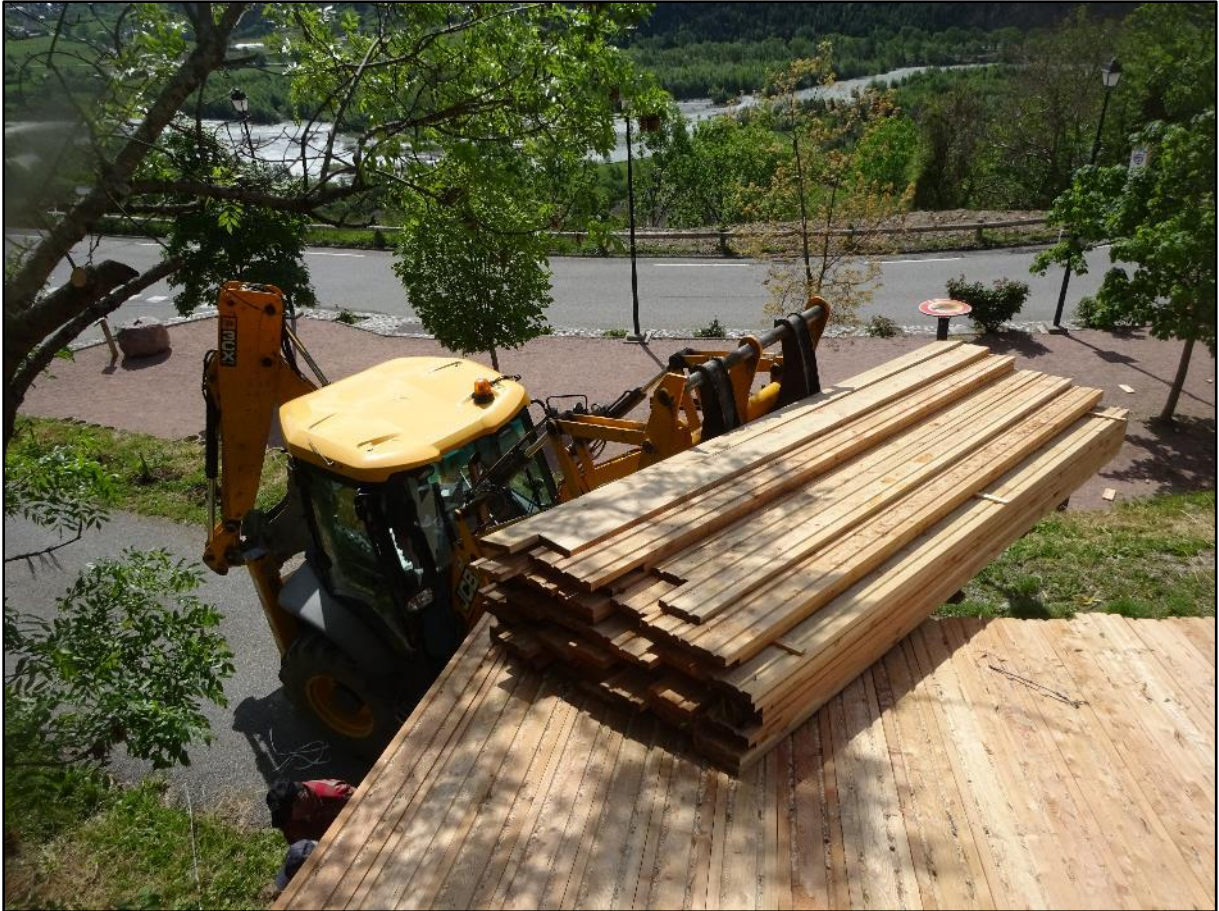
Image n°26 : sur le toit
