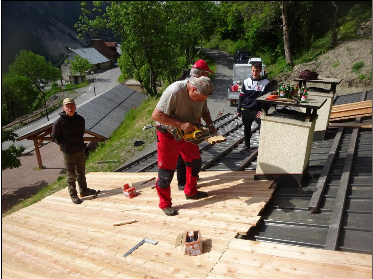
Image n°24 : sur le toit
