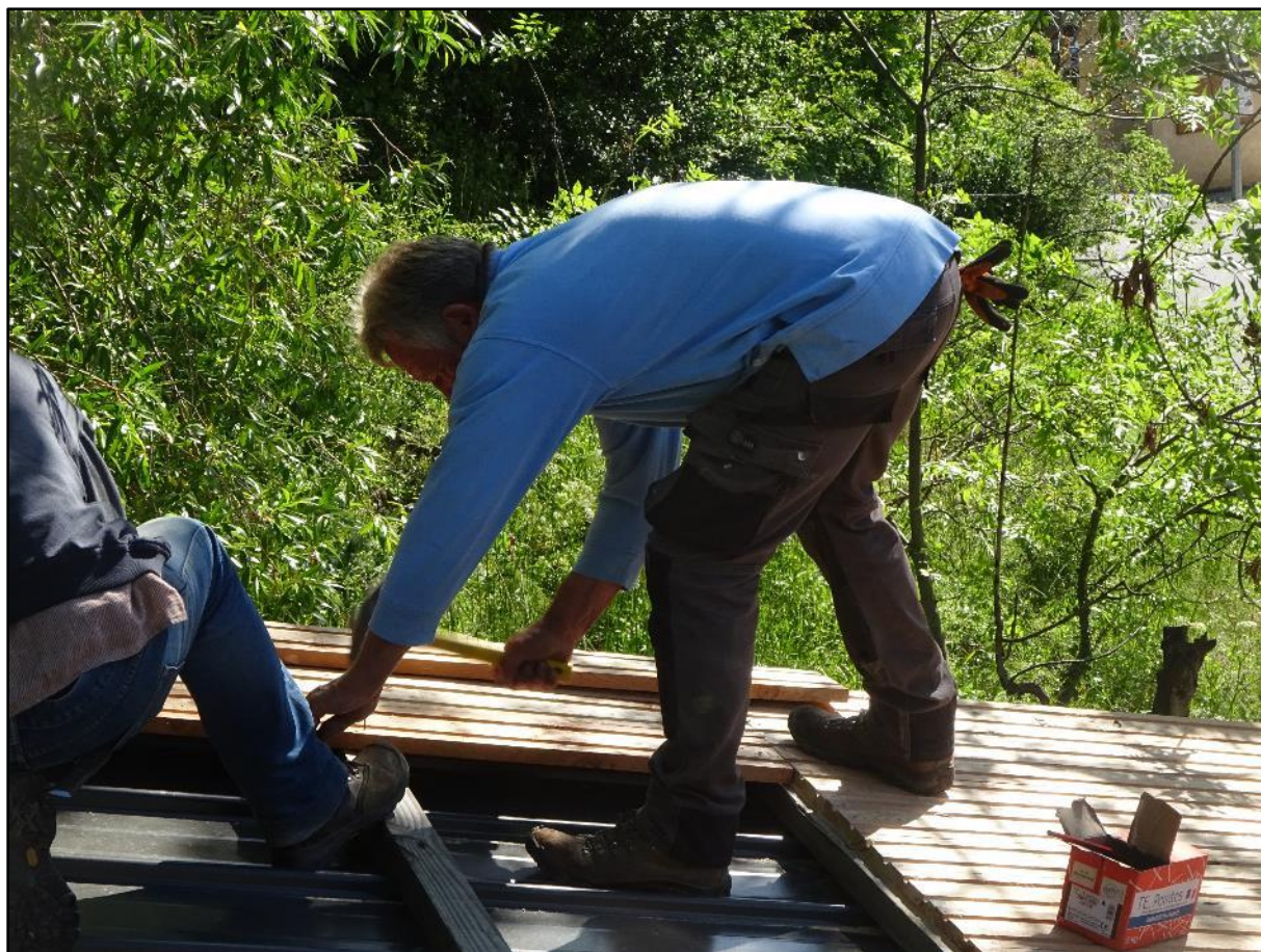
Image n°20 : sur le toit
