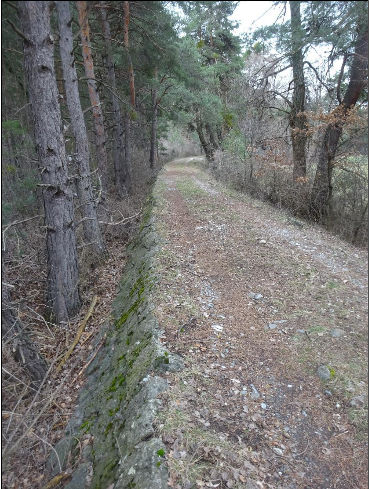
Image 15 : courbure de la digue
