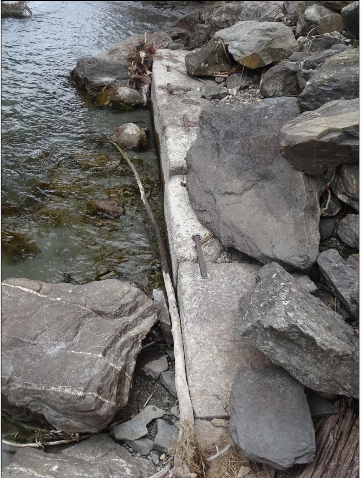
Vue vers l'aval. L'assise d'un ancien pont en blocs taillés de pierres roses de Guillestre rendues solidaires entre eux par des accroches métalliques.
