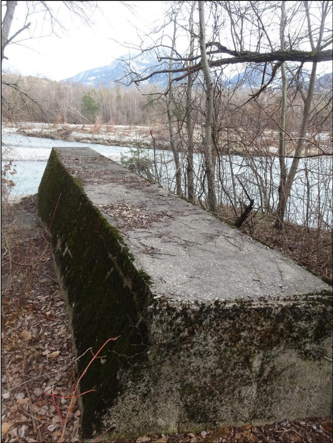
Image 22 : un épi en béton
