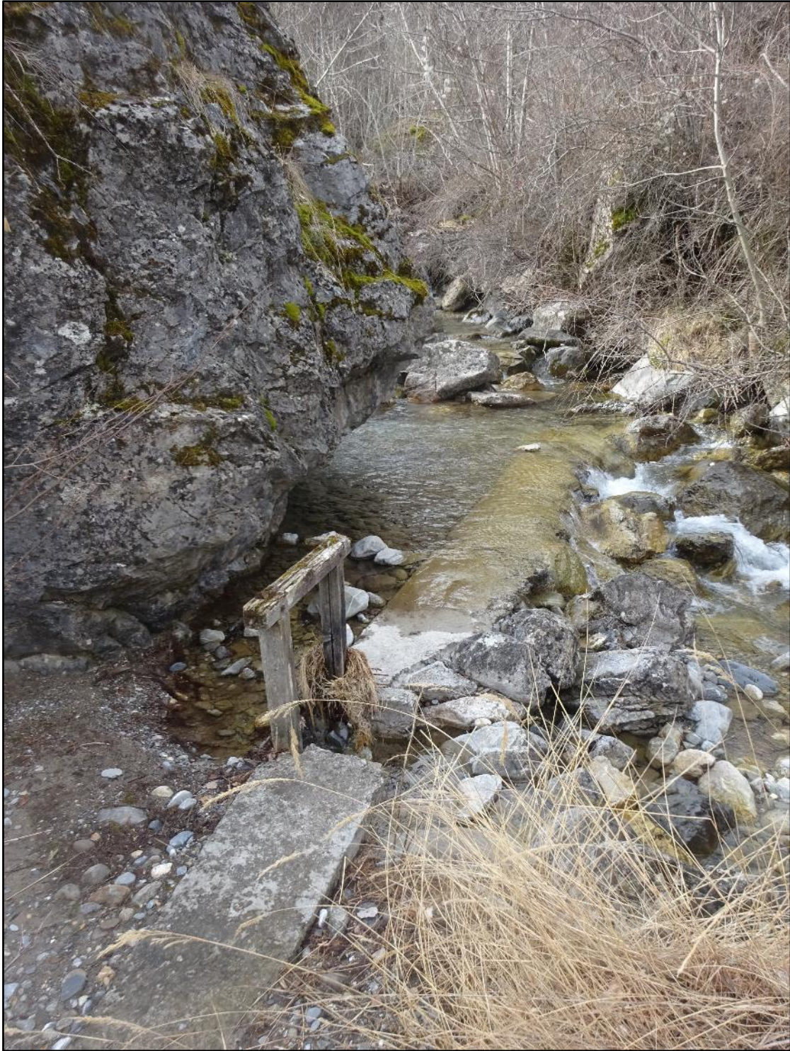
Image 18 : une prise d'eau avec martelière
