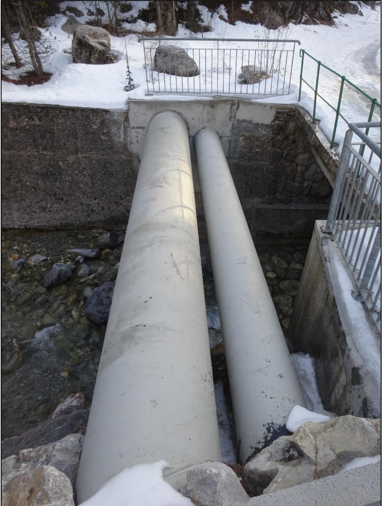
Image 8 : le passage des canalisations
