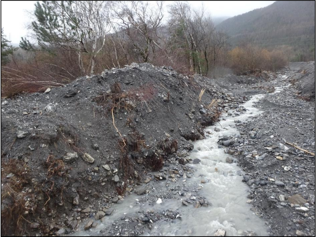
L'état de la rive droite en amont du pont.
