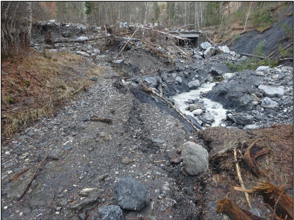
Image 1 : les restes du pont en amont du cône de déjection
