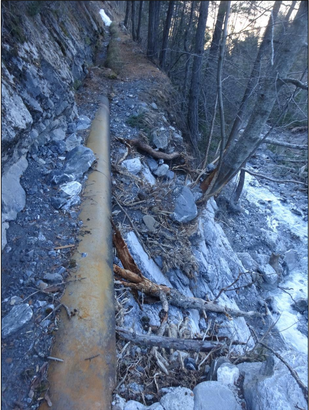
Image 2 : la conduite alimentant Barbein
