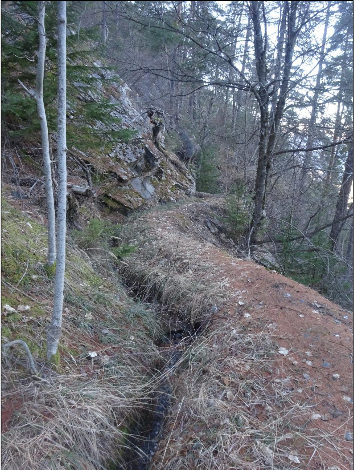
Image 7 : reprise du canal à l'ordinaire
