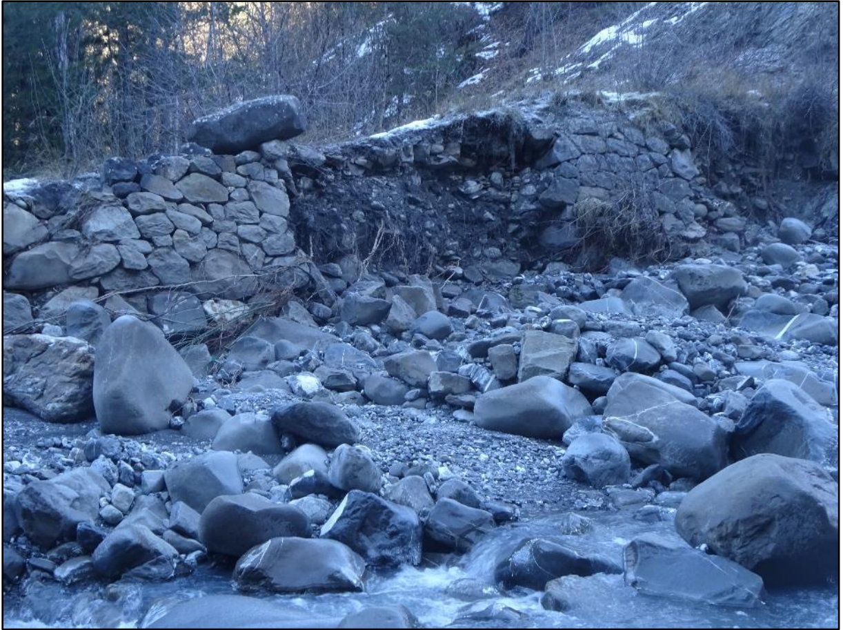
Image 19 : un mur qui a morflé
