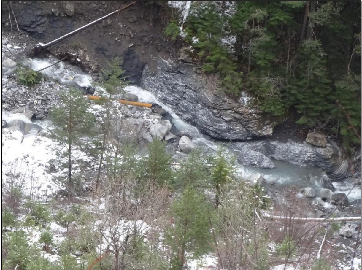
Image 24 : une tuyauterie dans le torrent
