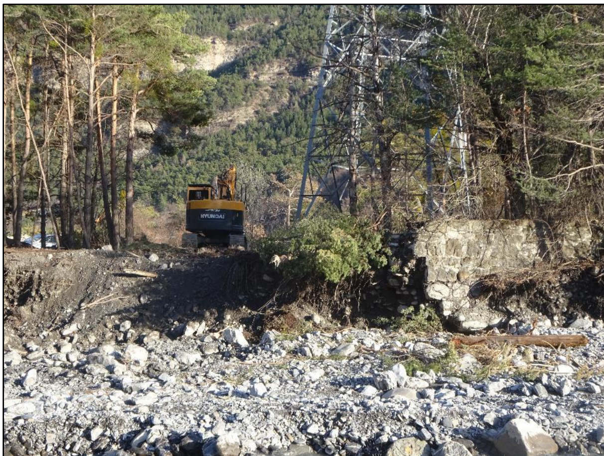
Image 14 : tracto et mur défoncé
