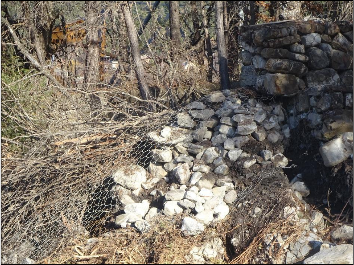
Image 15 : le reste d'un gabion
