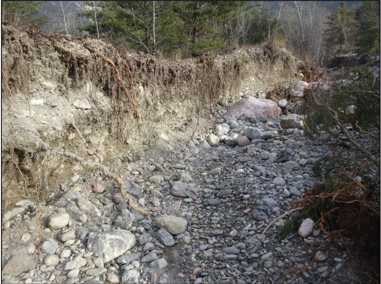
Image 24 : arrachement de berge
