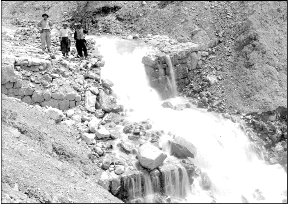
Image 19 : « Barrage n°8/2 endommagé (1904) »
