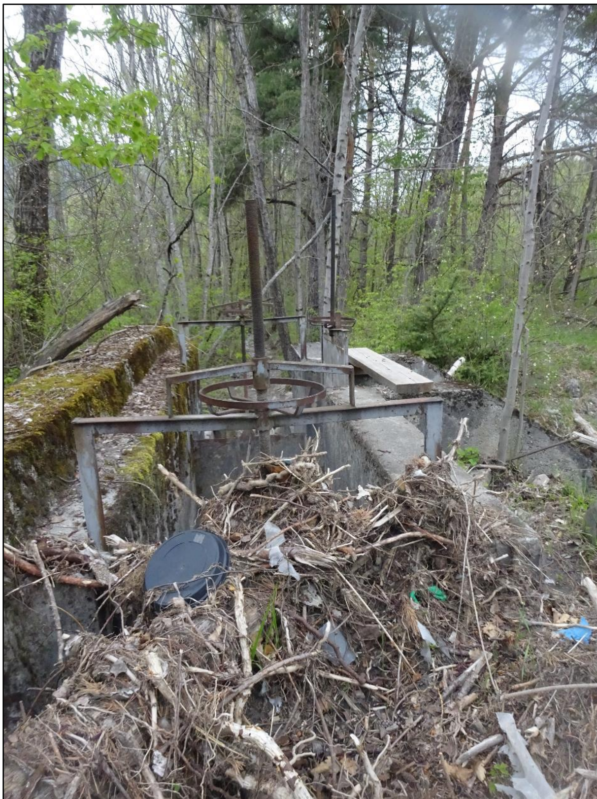
Image 13 : au niveau des vannes
