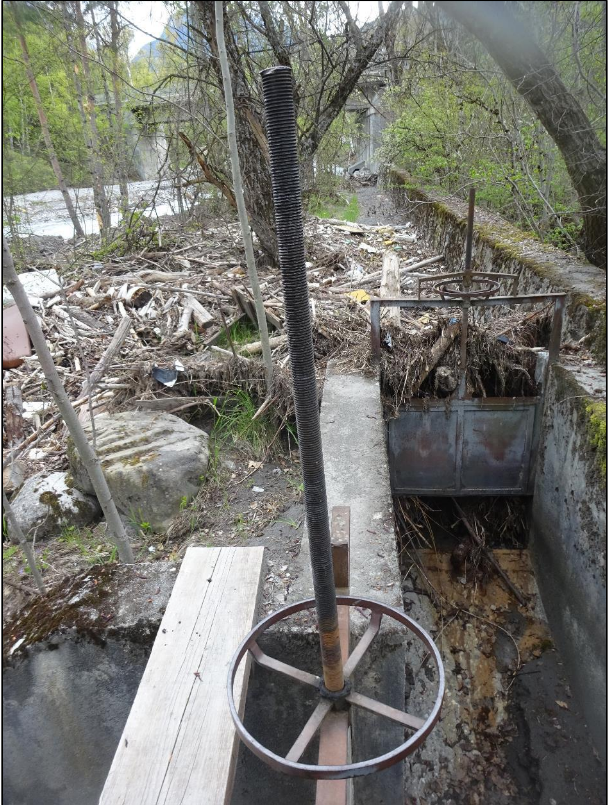
Image 14 : au niveau des vannes
