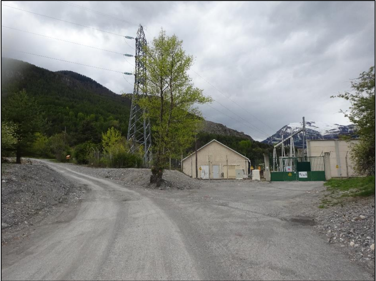
Image 3 : au poste électrique
