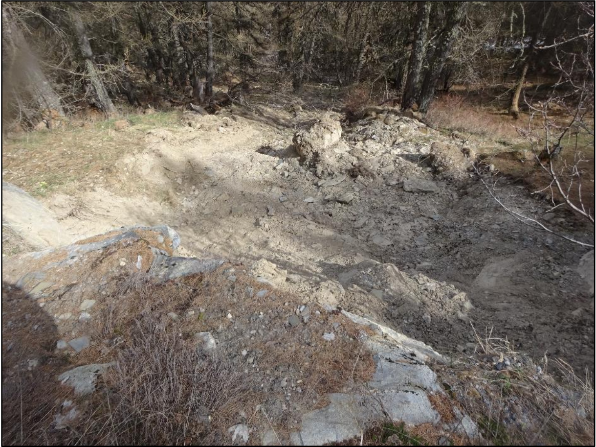
Image 13 : éboulement sous la piste
