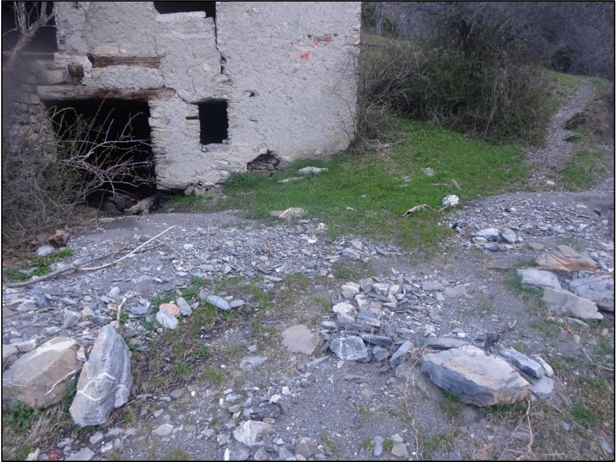
Image 6 : l'eau dans l'ancienne écurie
