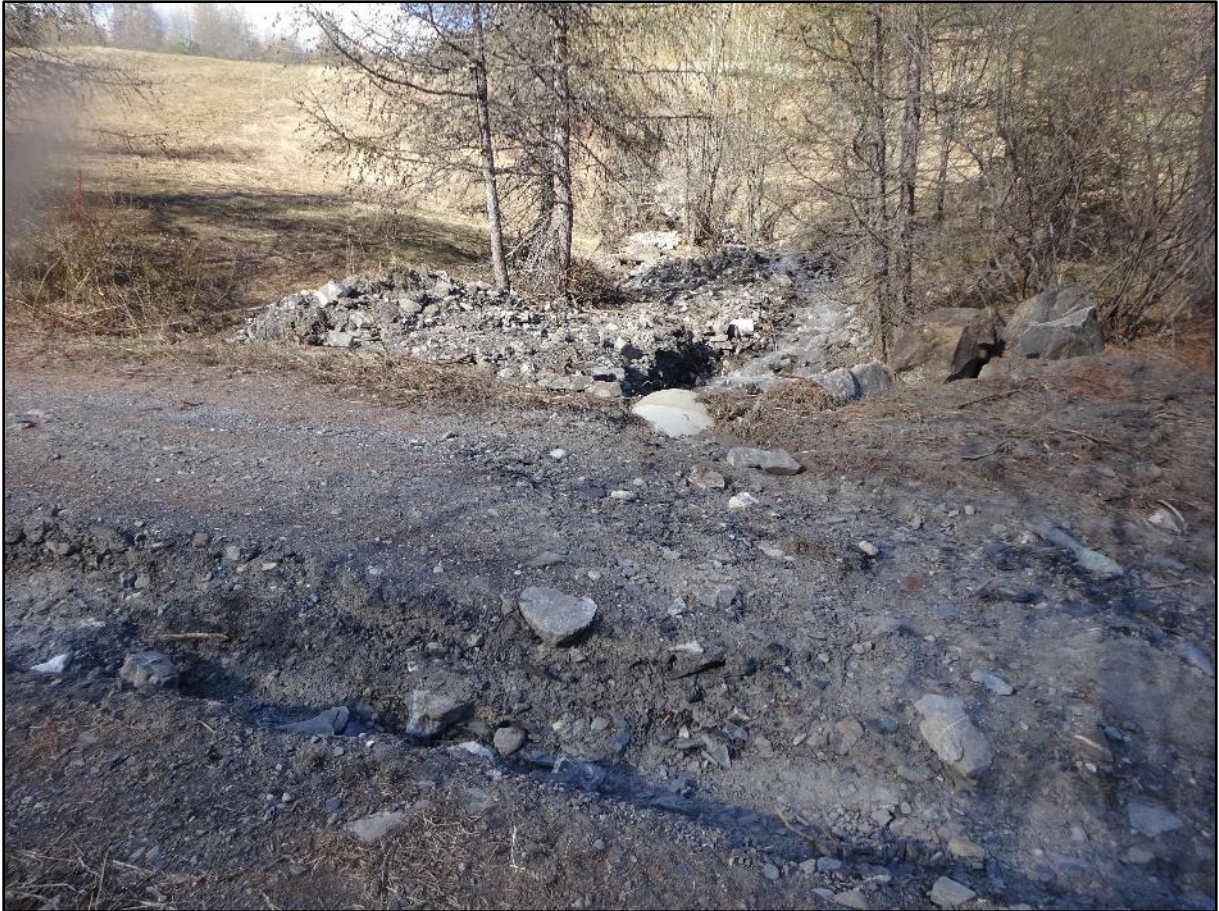
Image 16 : ravinement sur le chemin
