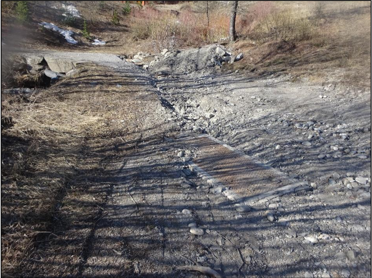
Image 15 : ravinement sur le chemin
