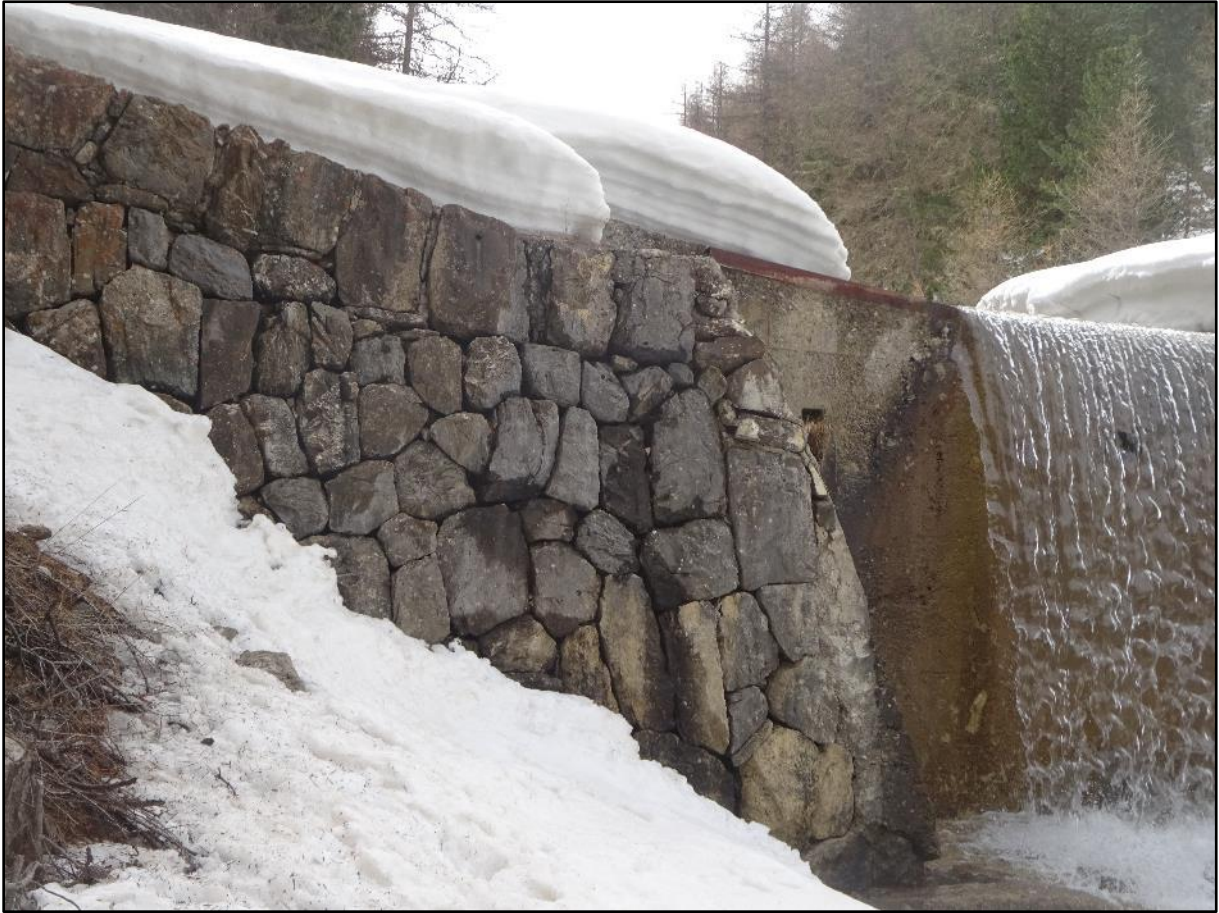
Image 32 : encore le même seuil
