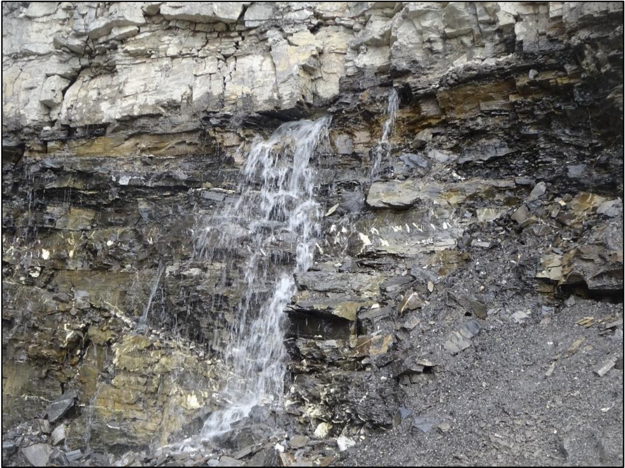
Image 25 : sortie d'eau d'une faille
