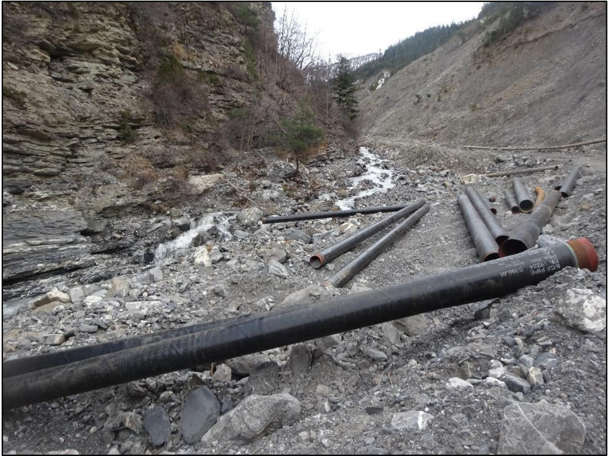
Image 22 : stockage de canalisations neuves
