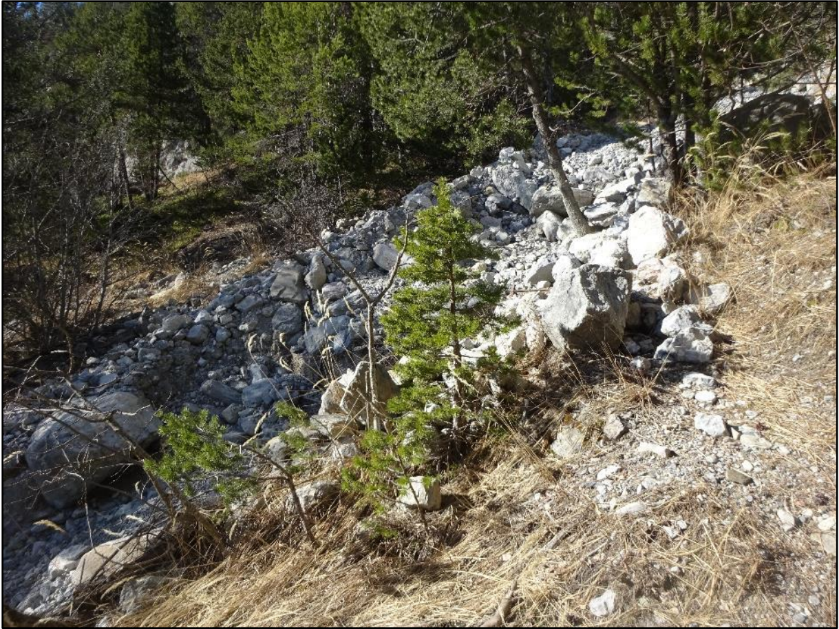
Image 5 : le sentier endommagé
