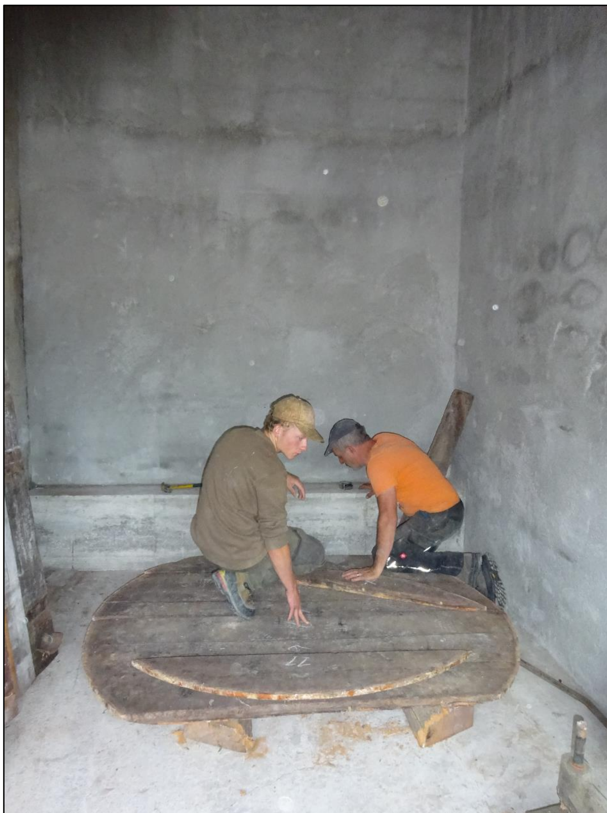
Image 104 : essai dans le local
