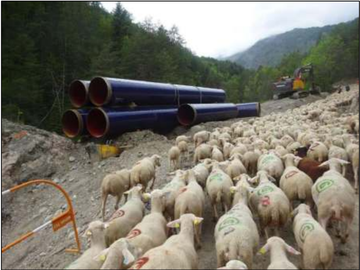
Image 41 : quelques tuyaux de la future conduite forcée
